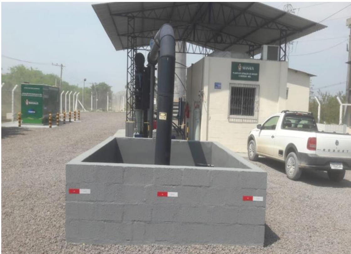
Figura 81 – Caixa separadora de condensados
